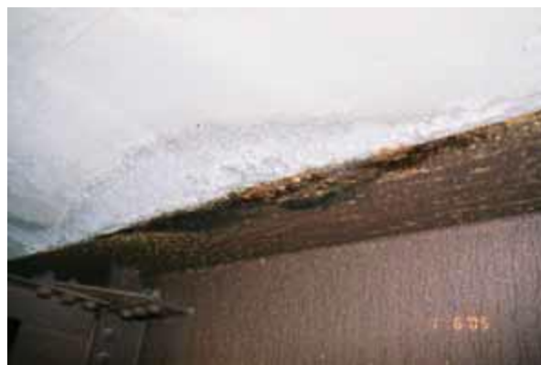
図－15 床版を浸透した漏水による腐食
