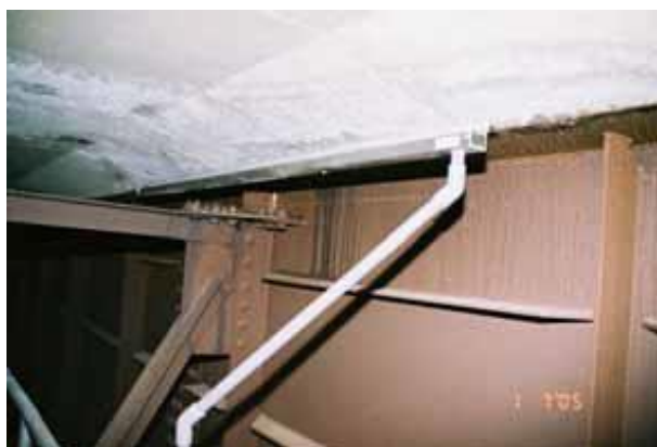
図-21 床版からの漏水に導水樋を設置した事例
