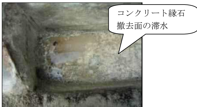
図-17 縁石部の滞水
