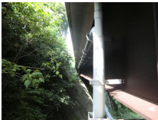
写真-17 地山斜面との近接状況 (配水管の横引きが影となり損傷が発生)
