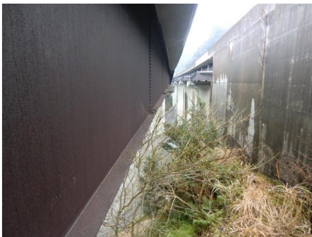
写真-24 立木の影響懸念箇所
