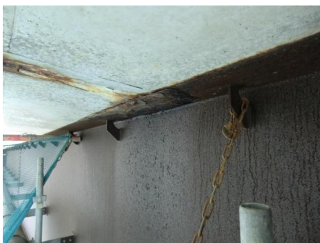
写真-1 外桁上フランジ下面・ウェブの損傷状況
