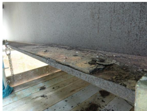
写真-2 外桁下フランジ上面の損傷状況
