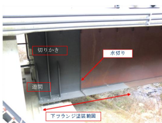
写真-14 桁端部の対応事例
