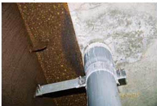
図－16 床版コンクリートと排水管の間からの漏水による腐食
