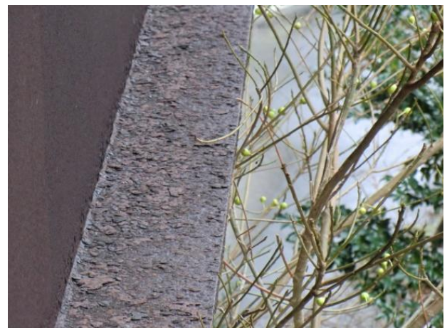
写真-25 植生箇所の異常さび
