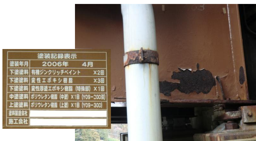
写真-26 補修塗装箇所のはく離
