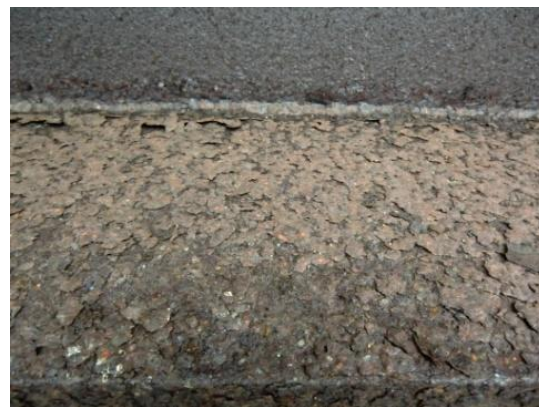
写真-20 下フランジ上面の損傷状況
