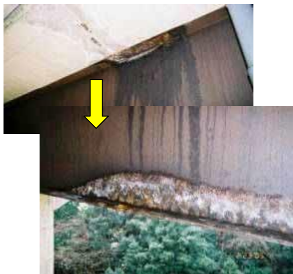
図－14 床版ひびわれからの漏水による腐食
