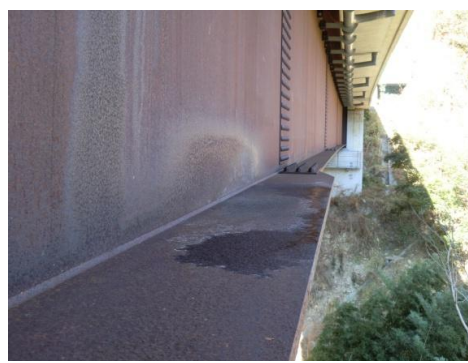
写真-4 配水管直下の外桁下フランジ上面の損傷状況
