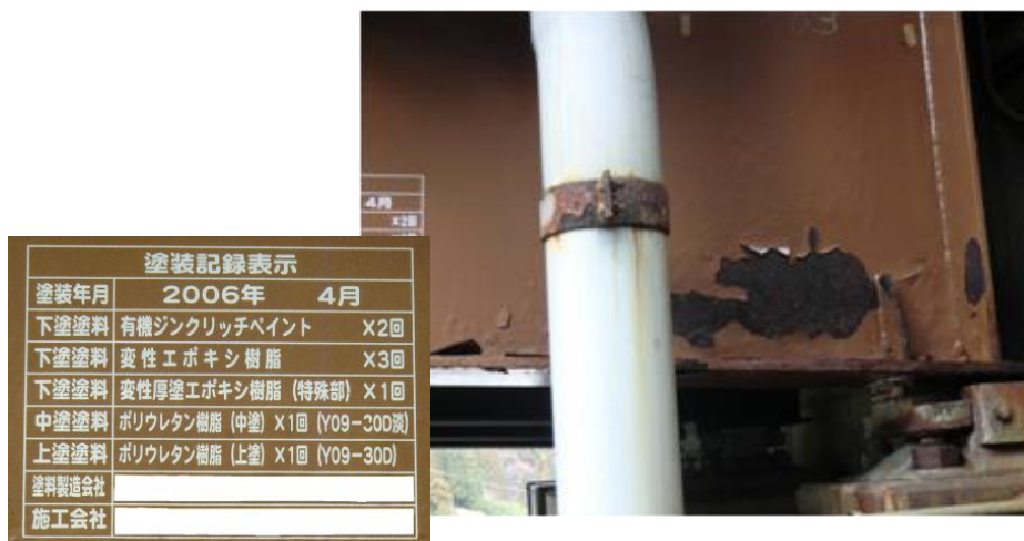
図5-1 補修塗装のはく離状況
