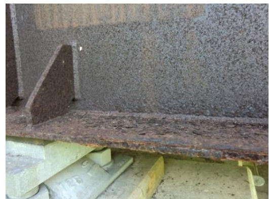
写真-18 桁端部の下フランジ上面の損傷状況
