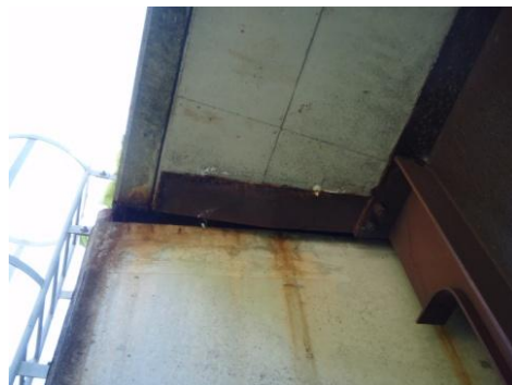
写真-10 伸縮装置の漏水による損傷状況
