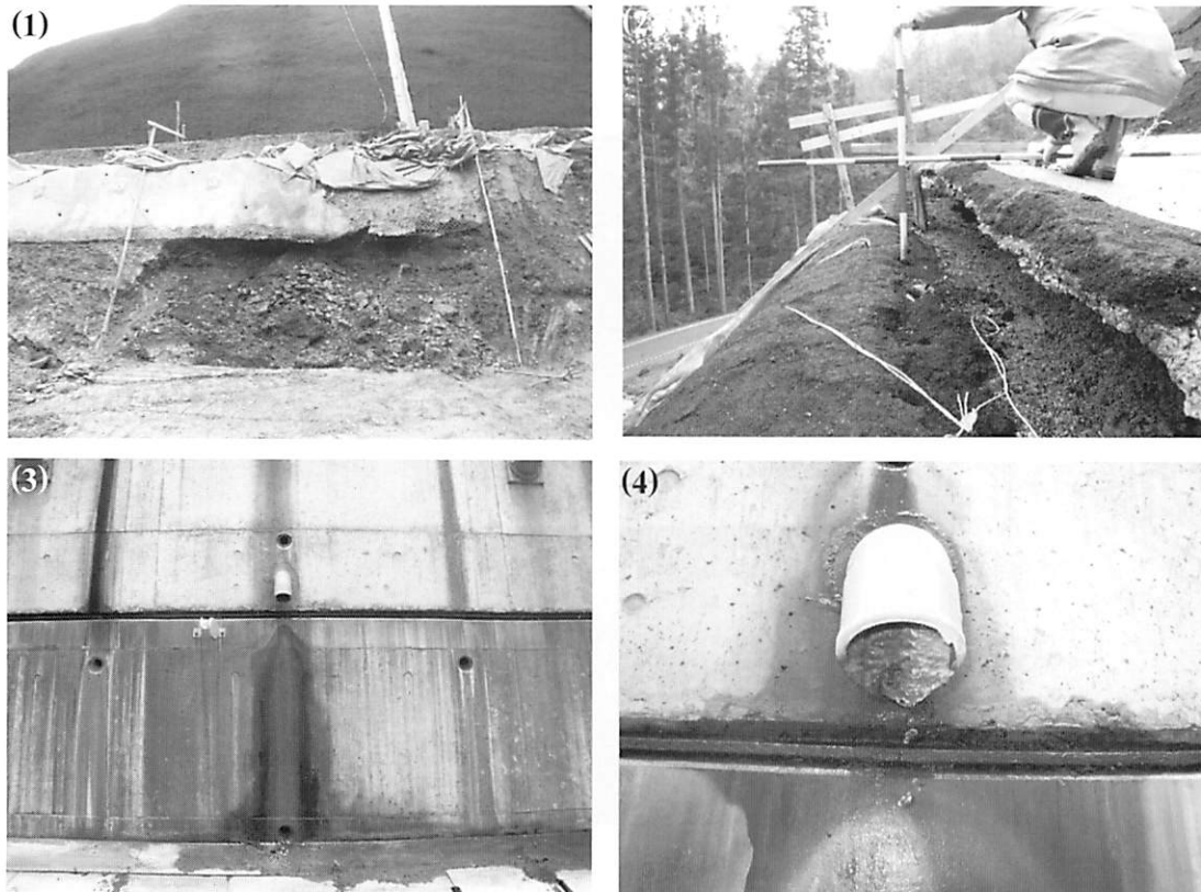
図3 地すべり面発生箇所の状況
