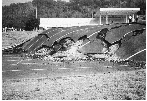
写真-2 台中縣霧嶺鄉綜合グランドの変位
