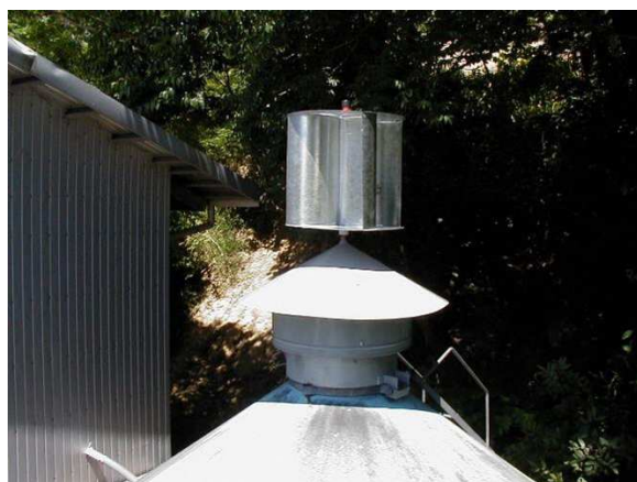
写真 1 タンク内の換気を促す装置
