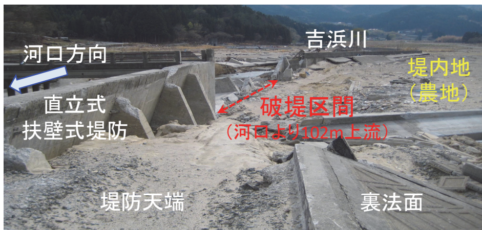
図-4 吉浜堤防の被災状況
