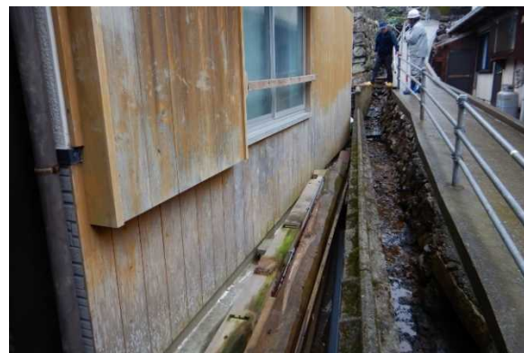
写真-3.4.1 B 出口付近の流出土砂の痕跡
