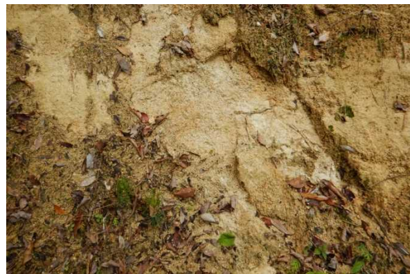
写真-3.4.13 0次谷⑧の崩壊面の土砂
